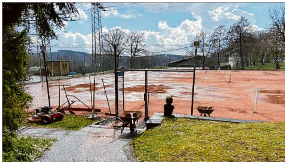
Die nicht mehr zeitgemäße Drainage sorgt dafür, dass nach stärkeren Regenfällen das Wasser auf den Tennisplätzen des TuS Ferndorf nicht schnell genug abläuft. Foto: Verein
